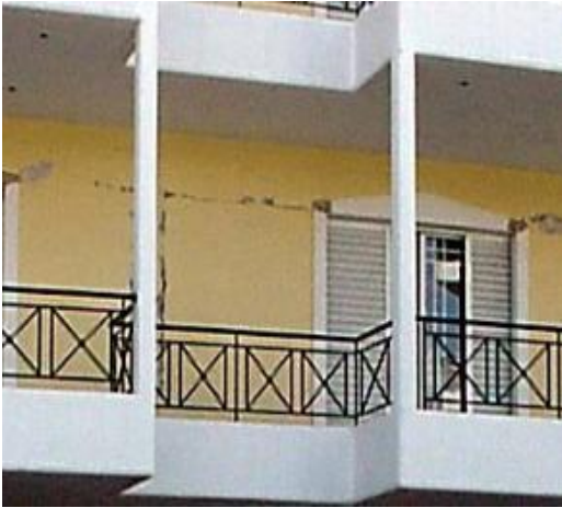
الصورة 22: شدة الضرر - الدرجة 2
