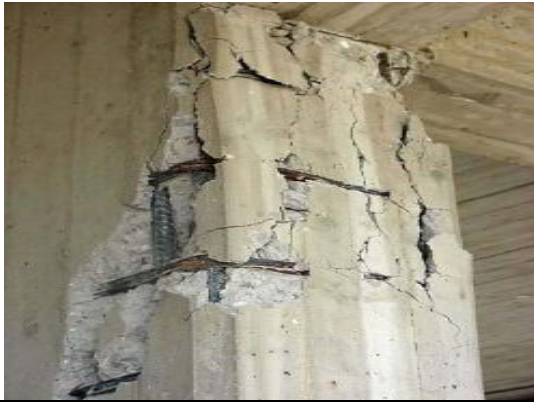
الصورة 4: شدة الضرر - الدرجة 3
