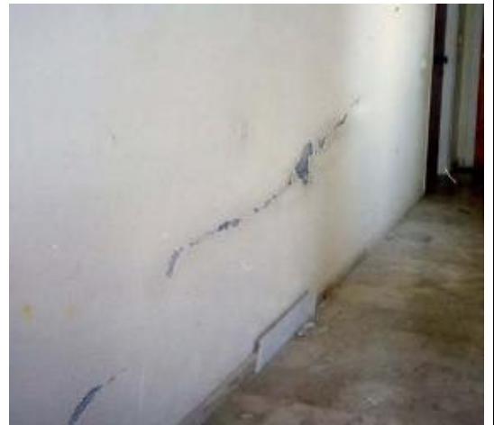
الصورة 21: شدة الضرر - الدرجة 2-1
