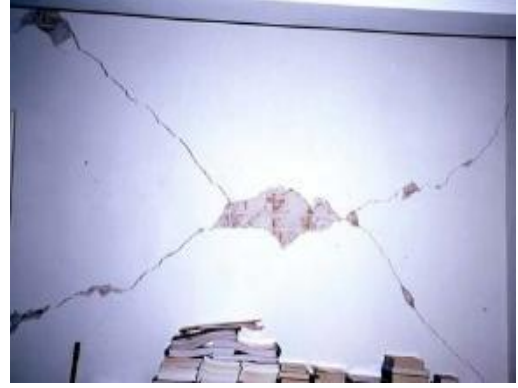
الصورة 23: شدة الضرر - الدرجة 3
