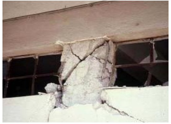
الصورة 7: شدة الضرر - الدرجة 4
