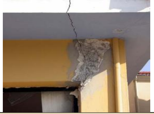
الصورة 13: شدة الضرر - الدرجة 2
