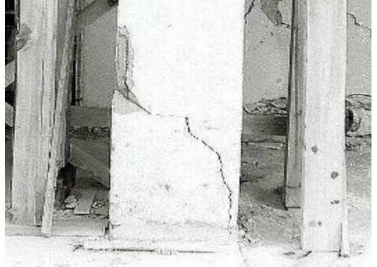
الصورة 5: شدة الضرر - الدرجة 3
