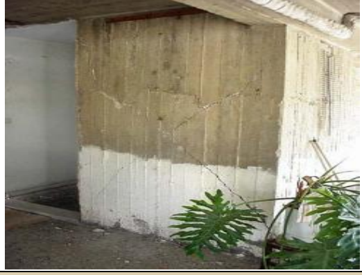
الصورة 9: شدة الضرر - الدرجة 2-3
