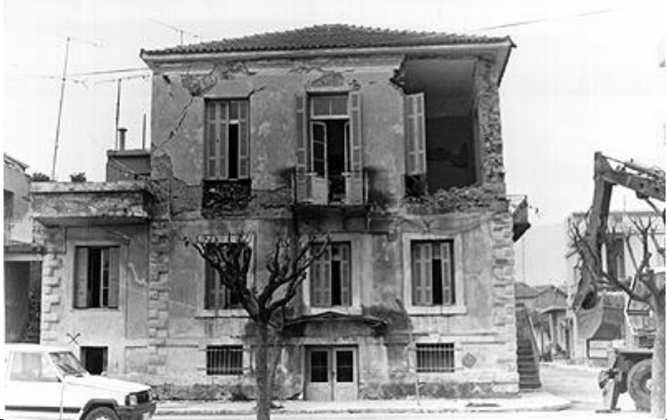
الصورة 32: شدة الضرر - انهيار جزئي "أحمر" -
