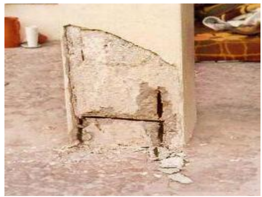
الصورة 1: شدة الضرر - الدرجة 1
