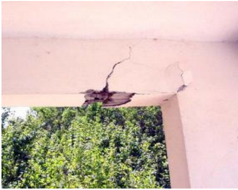
الصورة 16: شدة الضرر - الدرجة 3
