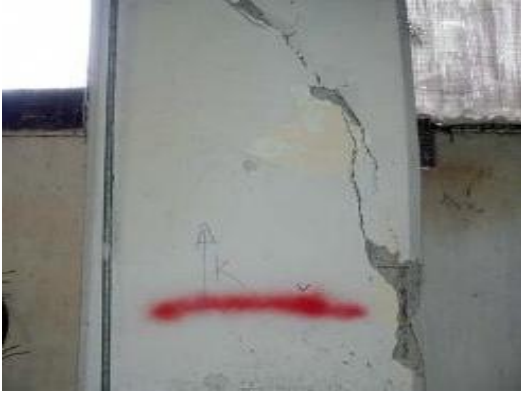
الصورة 6: شدة الضرر - الدرجة 3
