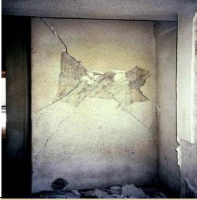
الصورة 10: شدة الضرر - الدرجة 2-3
