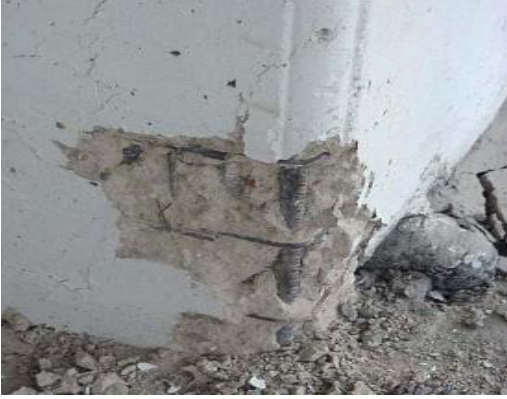
الصورة 2: شدة الضرر - الدرجة 1
