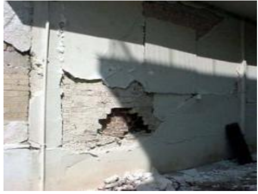
الصورة 25: شدة الضرر - الدرجة 4
