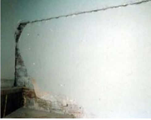
الصورة 24: شدة الضرر - الدرجة 3
