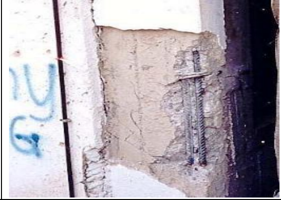
الصورة 3: شدة الضرر - الدرجة 2
