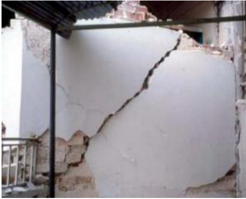
الصورة 26: شدة الضرر - الدرجة 4
