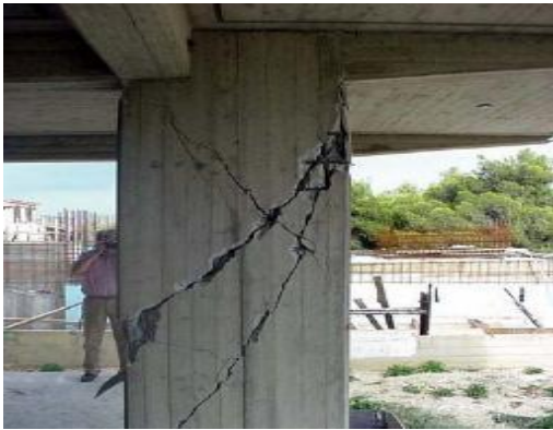
الصورة 8: شدة الضرر - الدرجة 4
