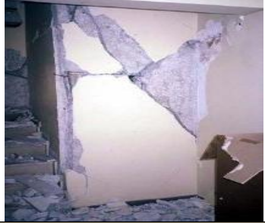
الصورة 11: شدة الضرر - الدرجة 4
