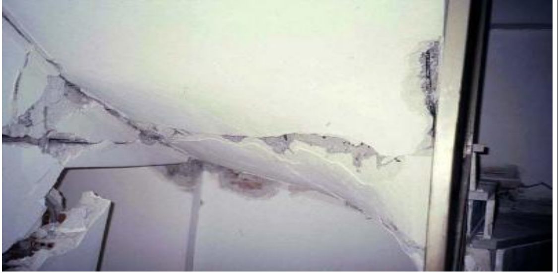
الصورة 20: شدة الضرر - الدرجة 3-2
