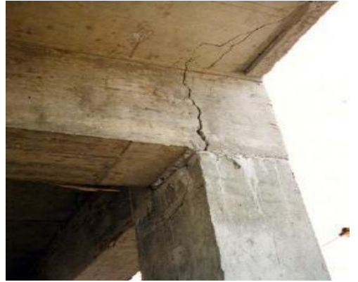
الصورة 15: شدة الضرر - الدرجة 3
