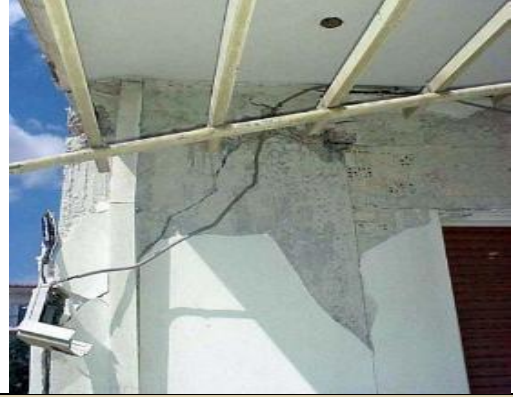
الصورة 17: شدة الضرر - الدرجة 2
