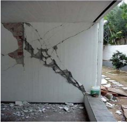
الصورة 12: شدة الضرر - الدرجة 4
