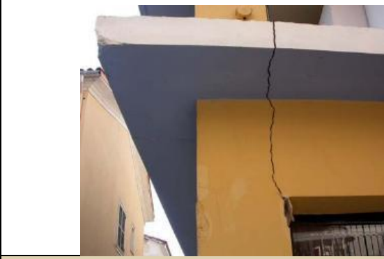
الصورة 14: شدة الضرر - الدرجة 2-3
