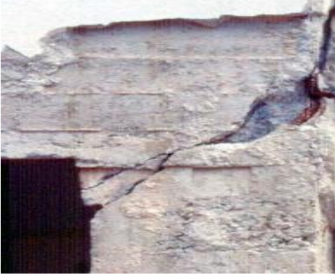
الصورة 18: شدة الضرر - الدرجة 2-3
