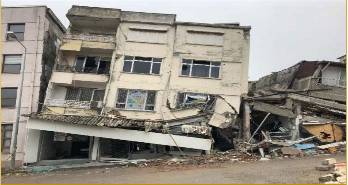
الشكل 07: نموذج لأضرار مركّبة في المباني السورية.
