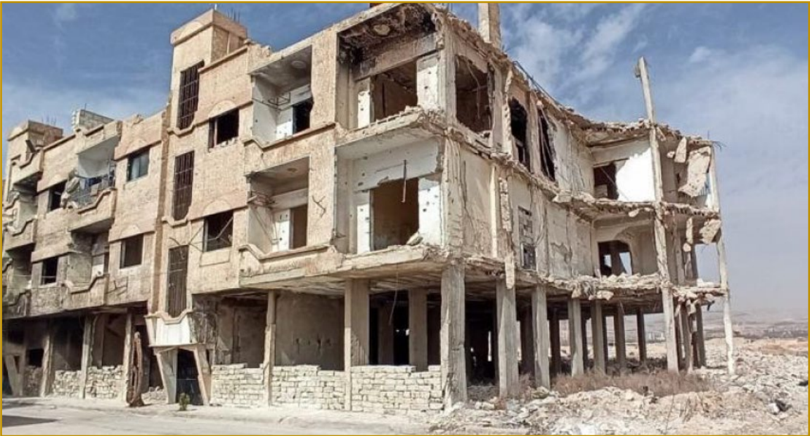
الشكل 19: صورة فوتوغرافية لأضرار إنشائية في مبنى سكني بسورية.
