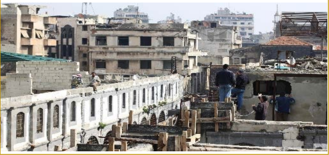
الشكل 06: نموذج لأضرار ناتجة عن إهمال وتقادم المباني في سورية.
